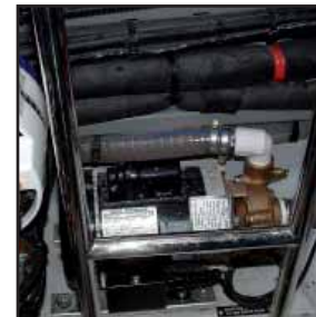
BOMBA DE CLIMATIZACIÓN
