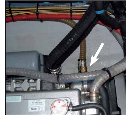
VÁLVULA DE TOMA DE AGUA MOTOR
