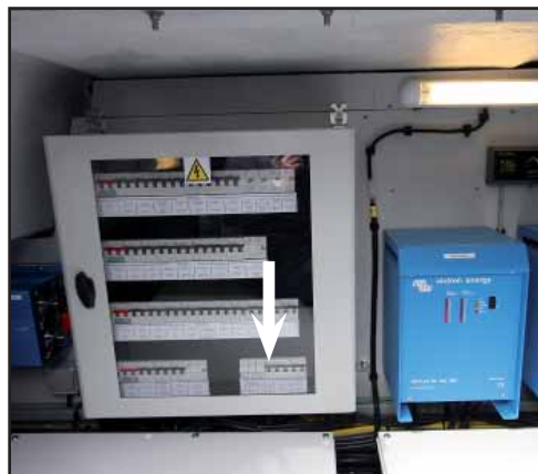
DISYUNTOR CIRCUITO 24 V
