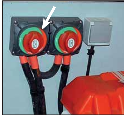
INTERRUPTOR DE ACOPLAMIENTO
