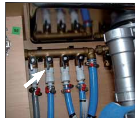
5 - VANNE D'ALIMENTATION EN EAU DOUCE DU LAVE-VAISSELLE
