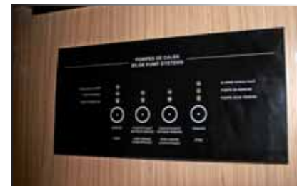
INTERRUPTEURS POMPES DE CALE ELECTRIQUES
