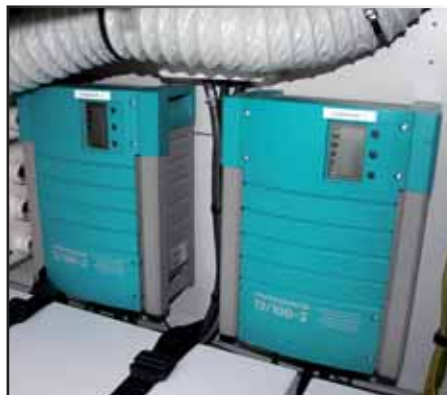
2 - CHARGEURS DE BATTERIES
