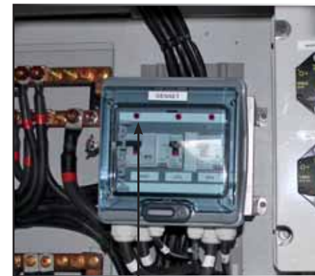
6 - DISJONCTEURS DU GENERATEUR
