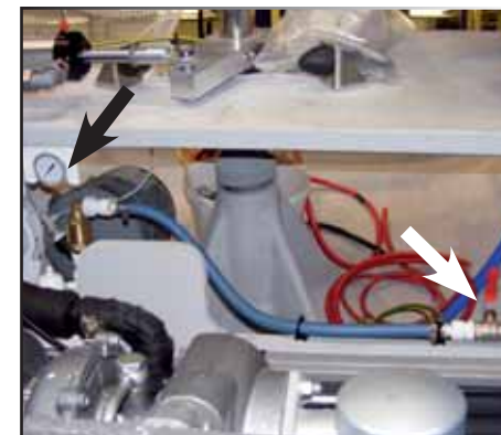
8 - MANOMETRE + VANNE DU CIRCUIT D'EAU DE REMISE EN PRESSION
