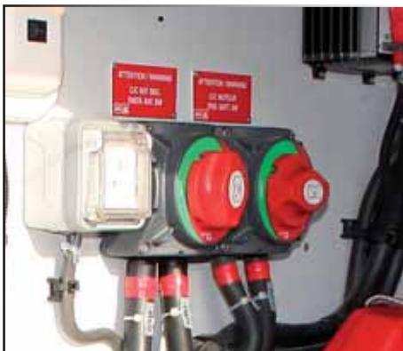
COUPE-CIRCUITS DE COUPLAGE + MOTEUR TRIBORD
