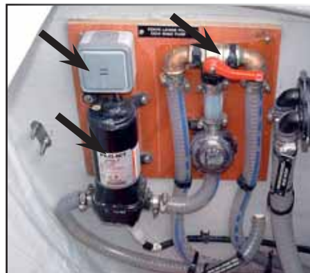
1 - 2 - INTERRUPTEUR + POMPE DE LAVAGE DE PONT + VANNE DE SELECTION
