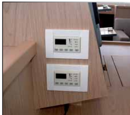
4 - COMMANDE DE CLIMATISATION
