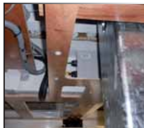
2 - BOITIER DE FUSIBLES DE ROOF
