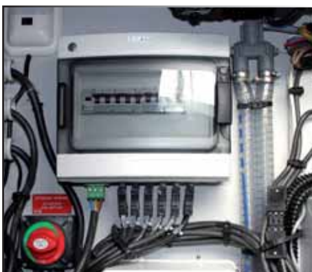
DISJONCTEURS ELEMENTS CLIMATISATION
