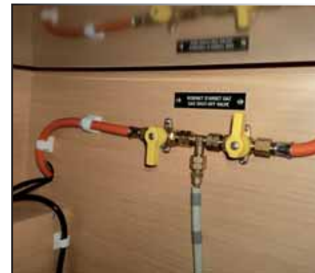
1 - VANNES DE GAZ
