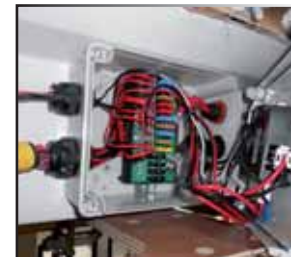
2 - BOITIER DE FUSIBLES DE ROOF
