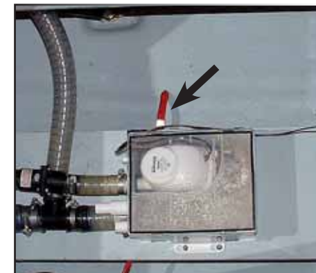
4 - VANNE DE PRISE D'EAU DE MER
