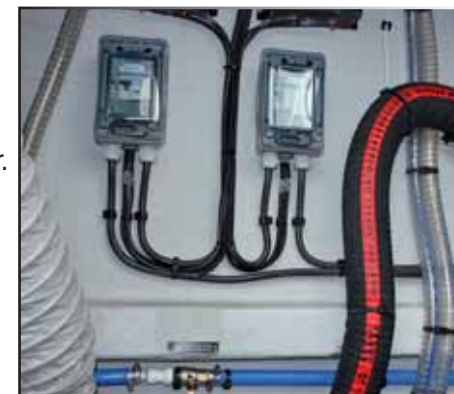
13 - DISJONCTEURS DE PRISES DE QUAI
