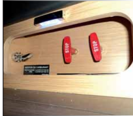
ZUGSCHALTER ZUM UNTERBRECHEN DER KRAFTSTOFFVENTILE AN BACKBORD
