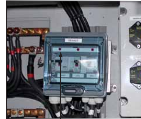
6 - SCHUTZSCHALTER DES GENERATORS
