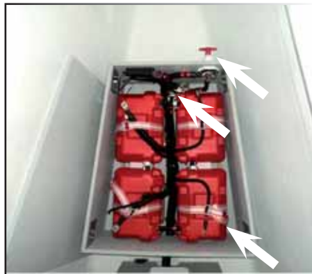
1 - BATTERIEN + SICHERUNG + STROMSCHUTZSCHALTER
