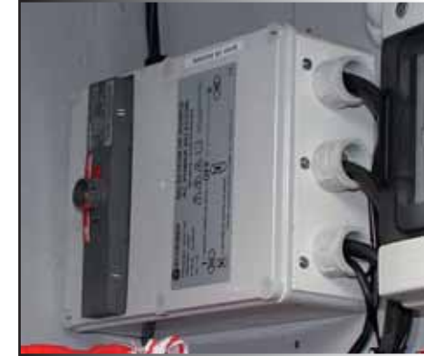
MANUELLE WAHLSCHALTER STROMQUELLE FÜR DIE KLIMAAANLAGE
