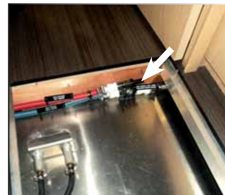
3 - WASSEREINLAUFVENTIL FÜR DIE WASCHMASCHINE
