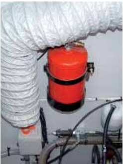
1- Feste Löschanlage in der Motorbilge (Zugang über die Motorbilgen)
